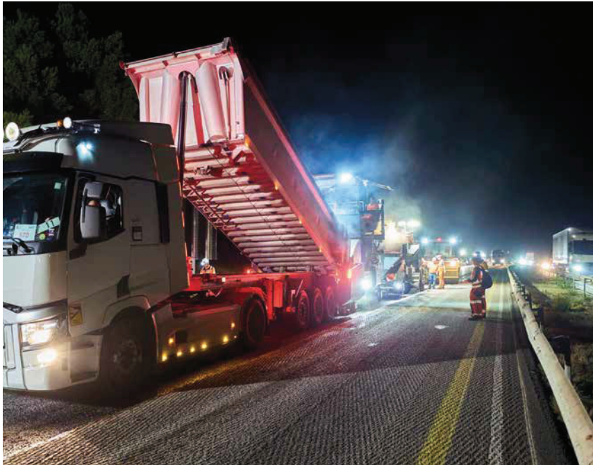
Sur ce chantier de rénovation de chaussée de l'A61 entre Carcassonne et Lézignan, une grande partie des agrégats d'enrobés de l'ancienne chaussée a été réincorporée dans la nouvelle.
