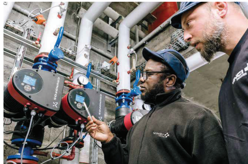
Le réemploi de matériaux issus de chantiers de réhabilitation ou de déconstruction (au premier plan, les chemins de câbles) se développe progressivement, en organisant la collecte, le reconditionnement et le stockage à l'échelle locale.
