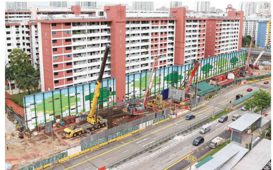
À Singapour, Soletanche Bachy réalise l'extension de la station de métro Ang-Mo-Kio, avec ses six entrées, ses deux passages souterrains par microtunnelier, sa tranchée couverte et ses deux tunnels creusés au tunnelier. Ce projet mobilise le tout nouveau modèle d'Hydrofraise® (HF8c) développé par Soletanche Bachy.
